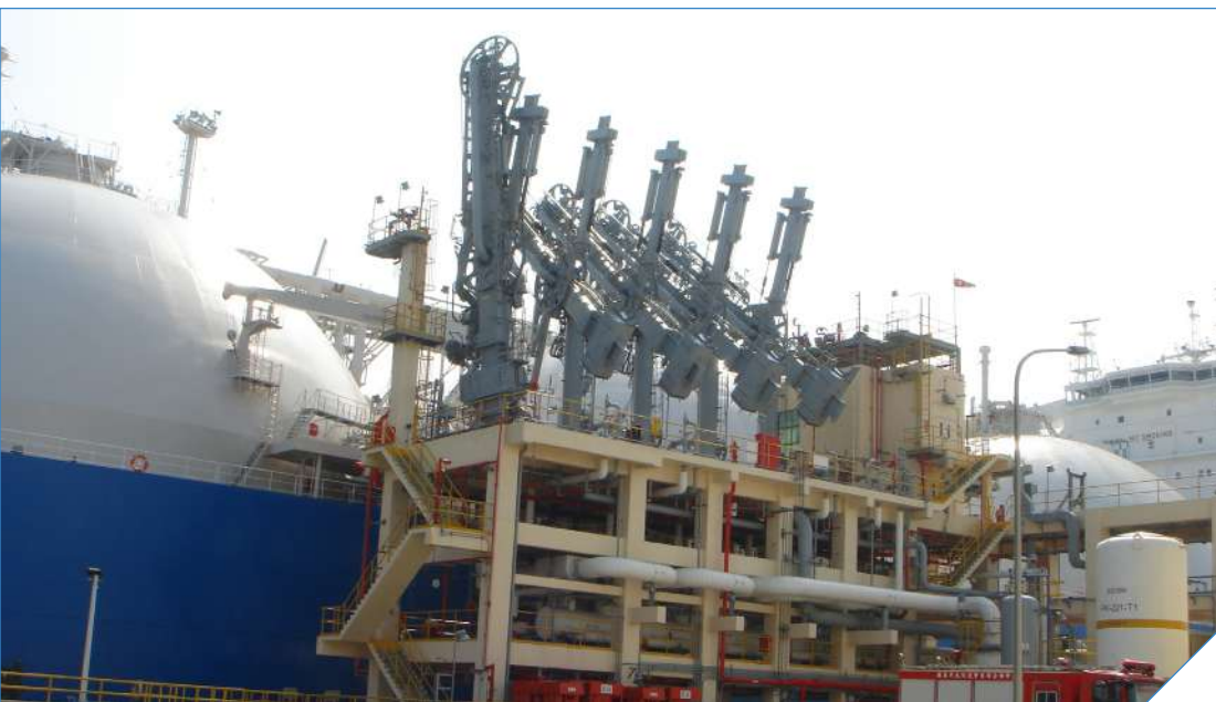
台灣中油公司 LNG 台中接收站
